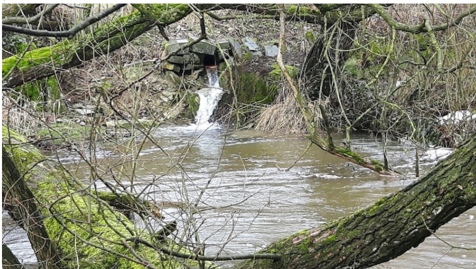
Verstopfen: Überbleibsel einer Tiefenbohrung in Atteln mit möglichen negativen Folgen für das Grundwasser bis Henglarn. Foto: Jürgen Vahle
